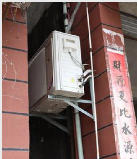
Improper location 安装不合理
